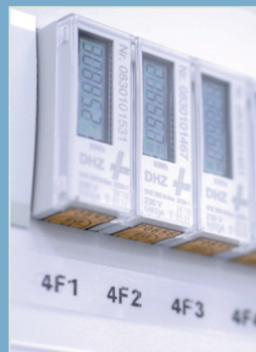
Zertifizierte Strommessgeräte je Kunde und Schaltkreis zur Überwachung und Abrechnung.
