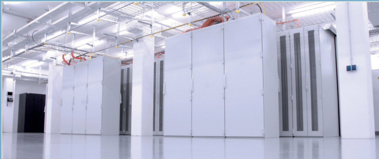
Belüftete Kundenracks (Rückseite) mit oben liegenden getrennten Faser- und Kupferkabeltrassen. Zentrale MMR/ODF-Racks (Vorderseite).
